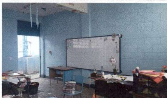
Foto 6: Pinturas en paredes internas.
